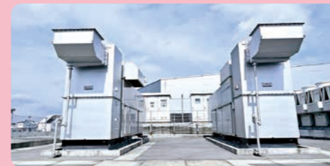
非常用発電機
