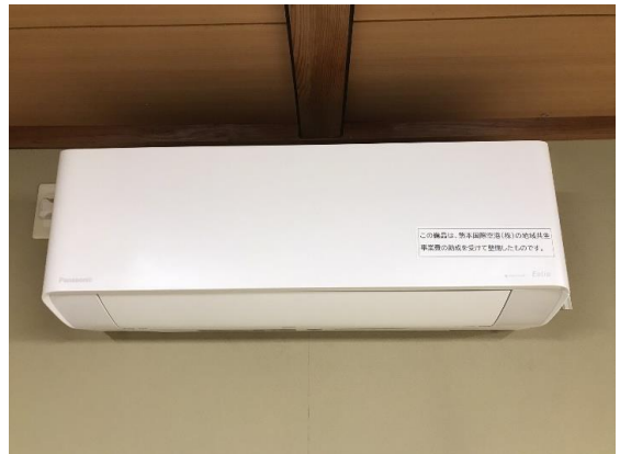
○大津町【②下陣内農業研修センター】 (エアコン)
