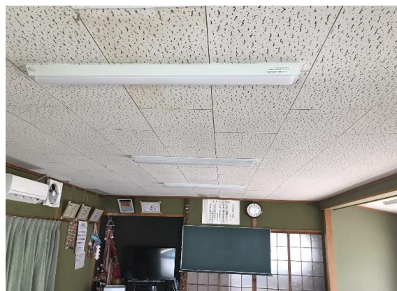
○益城町【④北向公民館】 (LED照明)
