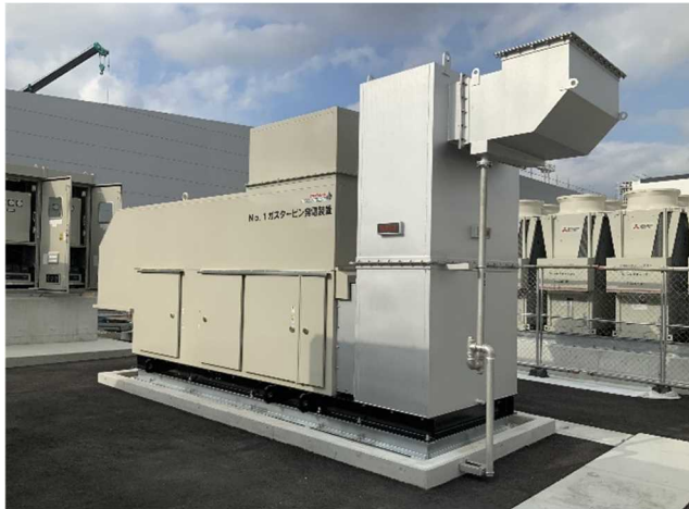
<非常用発電機>
